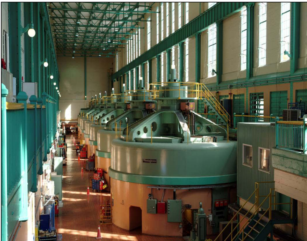
Groupes turbines-alternateurs, mis en service en 1928.
