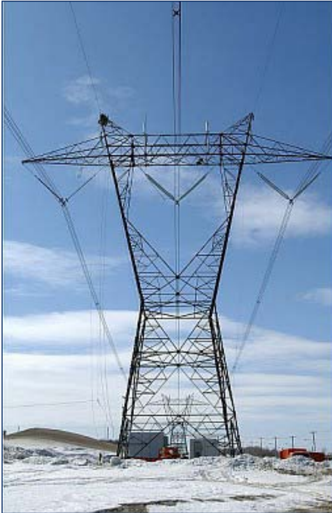
Ligne de transport à 735 kV, mise en service en 1965.
