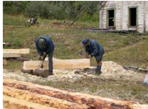
Wilfred Josie et Moses Lord en train d'équarrir une poutre Photo: PNGV et S. Smithlogs
